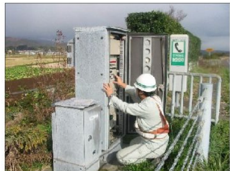
《通信設備の点検》東北道 本宮IC～二本松IC間
