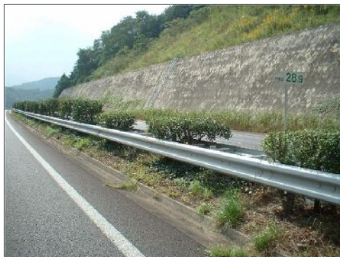
《中分防護柵(整備前)》
