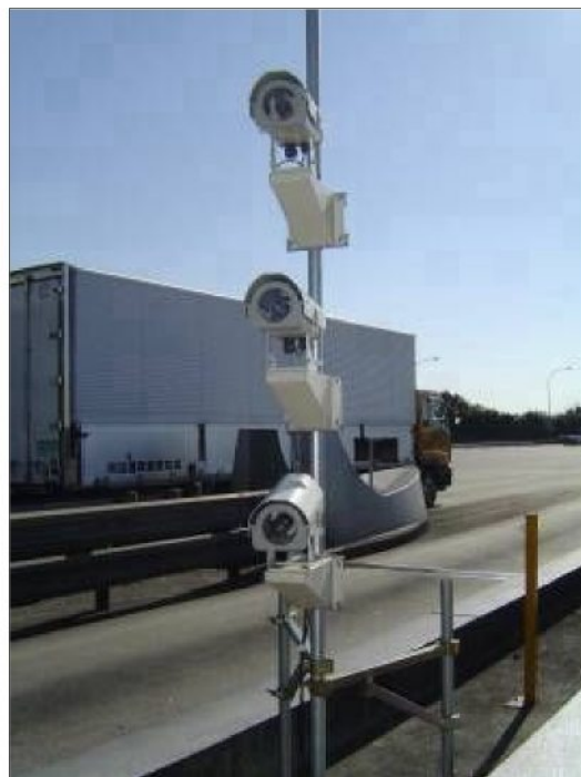
《不正通行対策用監視カメラ》
